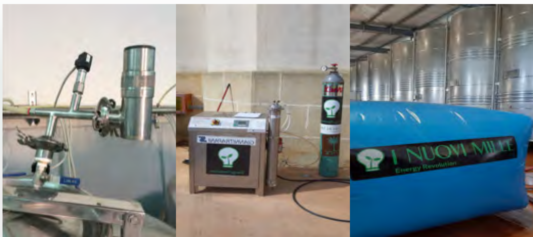
2 impianto di cattura CO2 di fermentazione
