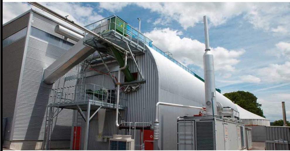
Kompogas® steel digester
